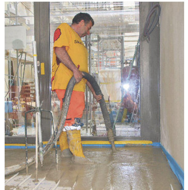
Dank des erleichterten und besser planbaren Einbaus ist der Boden wesentlich einfacher zu verarbeiten.
